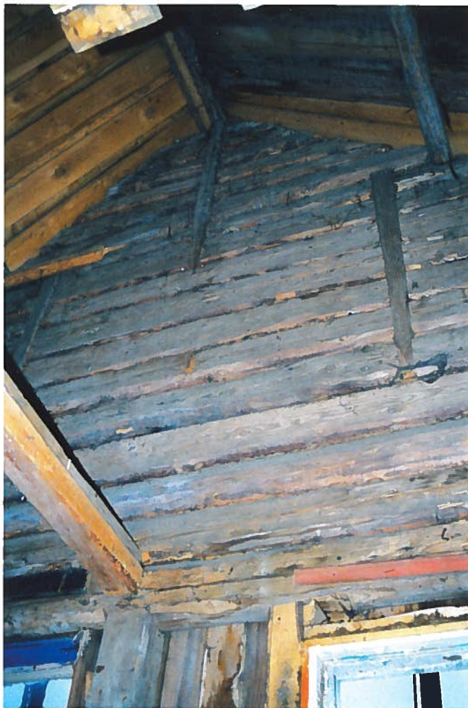
Spennede bygningsdetaljer kom tilsyne etter hvert som rivingen skred frem i bakstehuset på Hjelmbu.
